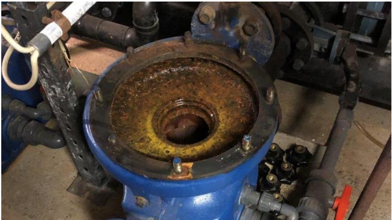
Eine der beiden Hauptpumpen: Ihr Zustand war schlechter als erwartet. Foto: MUP
